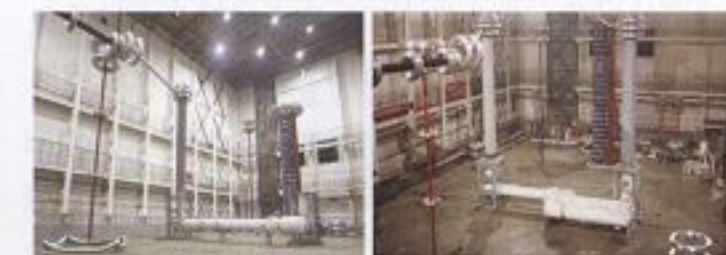
图 9 GIS 绝缘试验进行中 图 10 断路器绝缘试验进行中
